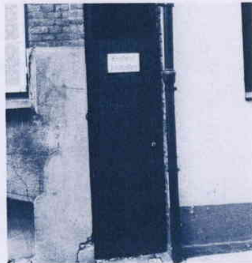
Brandgänge sind oft durch Türen verschlossen.
