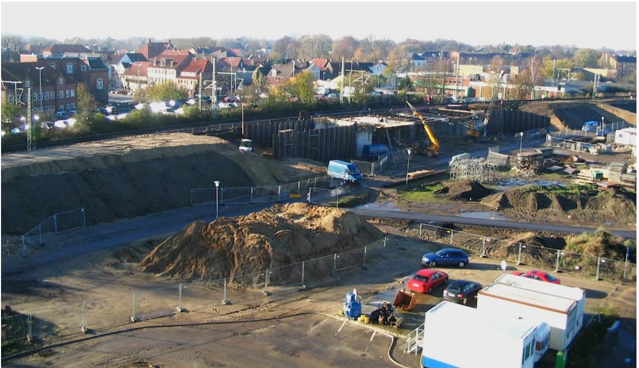
Der Erdbau der Dammverlegung ist abgeschlossen, die Bahnbrücke befindet sich im Rohbau, November 2005
