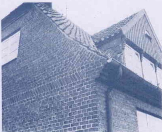
Beachten Sie die unterschiedliche Lage der Ziegel am Ortgang und im Bereich der Erdgeschoßdecke.
